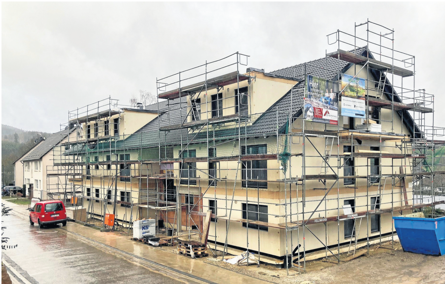
Das Acht-Familien-Haus der Heimat-Tal AG am Oberen Königsberg in Würdinghausen soll im zweiten Quartal 2023 fertig sein. VOLKER EBERTS
